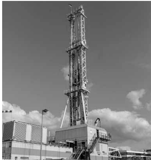
Foto: © Geothermie Freilham, SMM, Steffen Leiprecht
